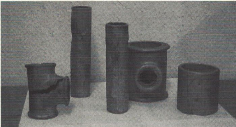
Kaum verlegt und schon undicht. Rohre aus einem Vereinsgelände.
